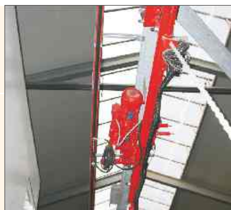
Stroomvoorziening en loopwerk.
